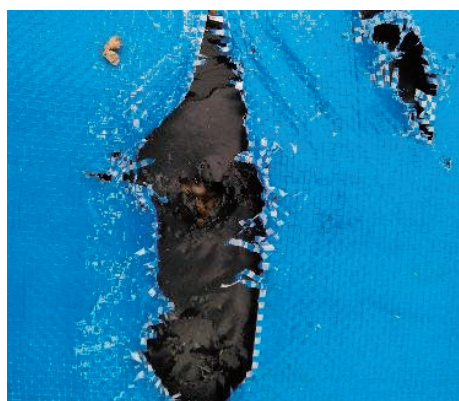
写真3 シートに穴が開いている様子
