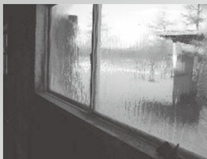
結露した窓。日中の暖かい時間帯だけでも換気しましょう
