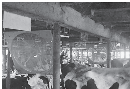
写真1 つなぎ牛舎の通路に送風機を設置している事例
