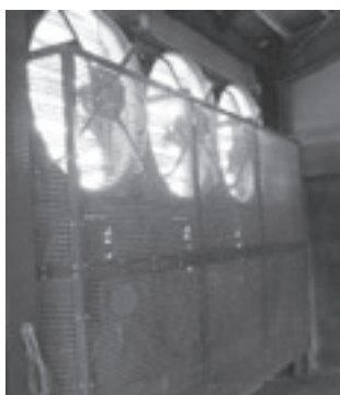
換気扇に設置した安全カバー
