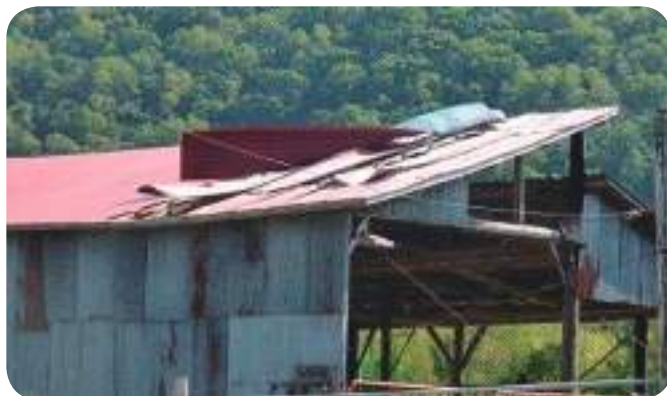
育成舎の屋根破損（音別）
