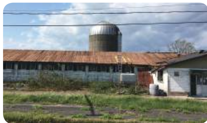
牛舎の屋根破損（鶴居）
