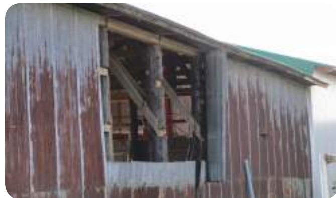
破損した倉庫（幌呂）
