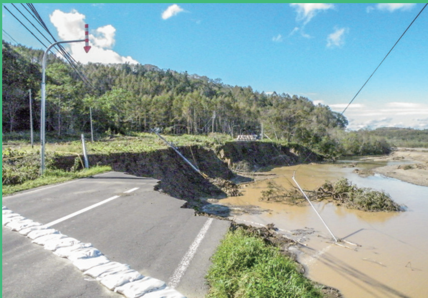
河川の氾濫で道路が決壊（白糠町庶路）
