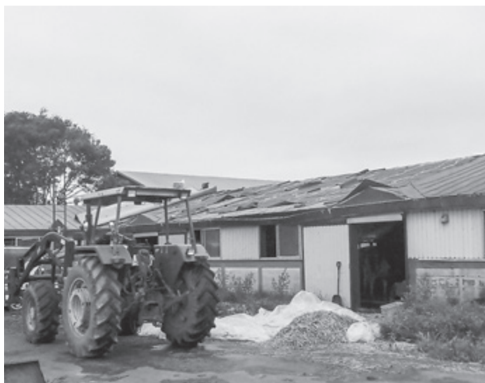
幌呂地区の損壊牛舎
